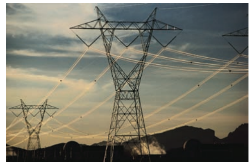
Fotografía 7.4 En esta sección se exponen las fuerzas sobre los apoyos y las fuerzas internas en los cables de las líneas eléctricas que se muestran en la fotografía.
